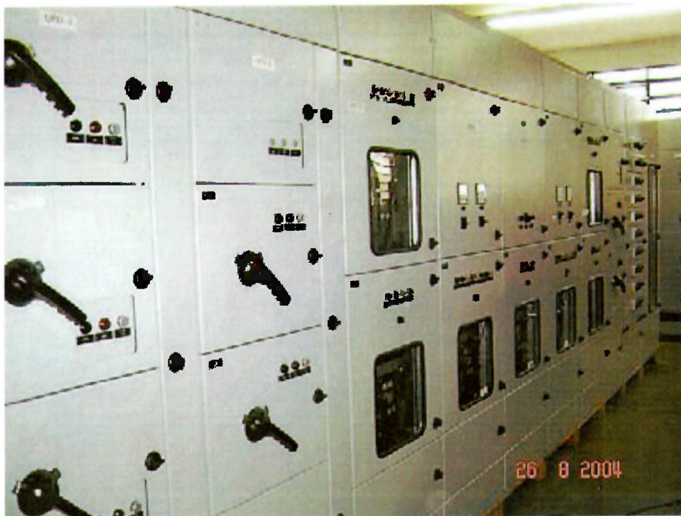
Figura 6.7 – Quadro de distribuição de força em baixa tensão. Fonte: LAVILL
