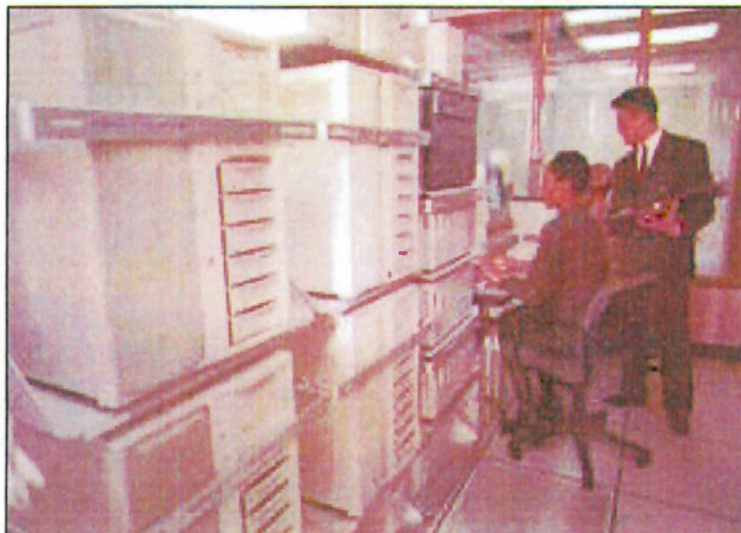
Figura 4.1 – Sala elétrica de controle. Fonte: VESDA
