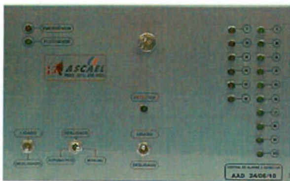
Figura 6.18 – Central de alarme tipo convencional. Fonte: ASCAREL
