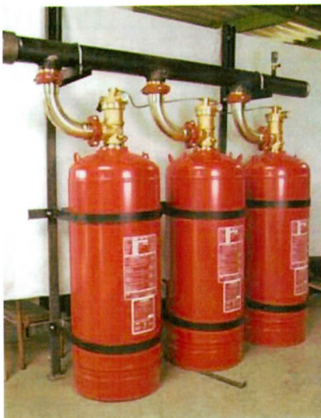
Figura 6.26 – Bateria de instalação de Gases limpos. Fonte: RMR
