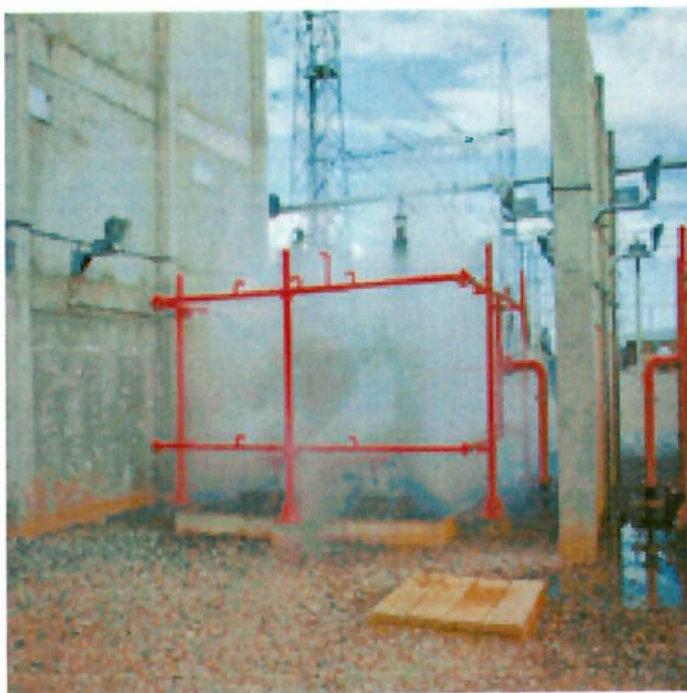
6.27 – Aplicação de sistema water spray. Fonte C. M. Couto
