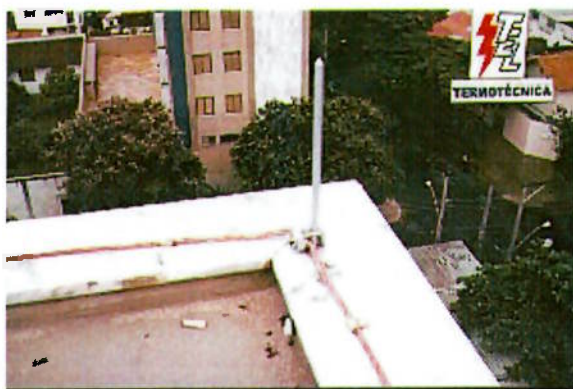
Figura 5.5 – Malha de SPDA com captor. Fonte: TERMOTECNICA
