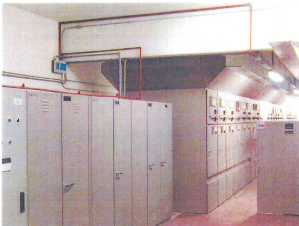
Figura 4.2 – Sala de painéis de AT e BT. Fonte: VESDA
