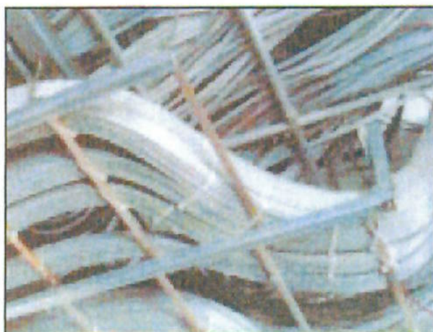
Figura 5.3 – Leito de cabo. Fonte: HILT
