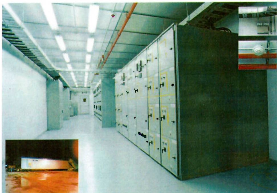
Figura 4.5 – Parte interna de um eletrocentro. Fonte: EATON
